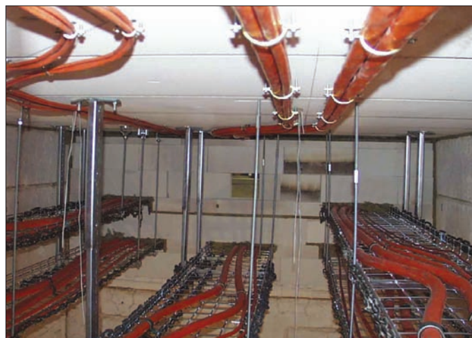
Fig.3. Aranjarea cablurilor în cuptorul de test
